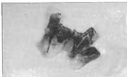
Fig. 4-4 Vue après extraction de l'infiltration des oxydes métalliques due à la corrosion (ayant entraîné des fêlures et fractures multiples)
